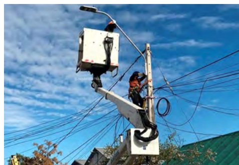
Recambio de luminarias LED en Puente Alto presenta un 44% de avance - Somos Puente Alto
